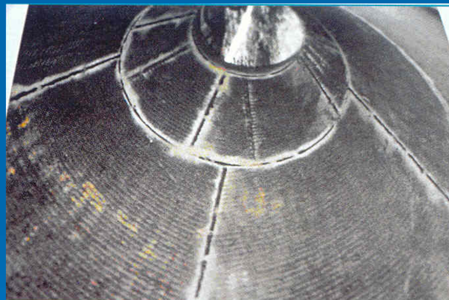
Widok odcinka rury transportu pneumatycznego materiałów sypkich o powierzchni wewnętrznej wyłożonej pyłą ścierną
